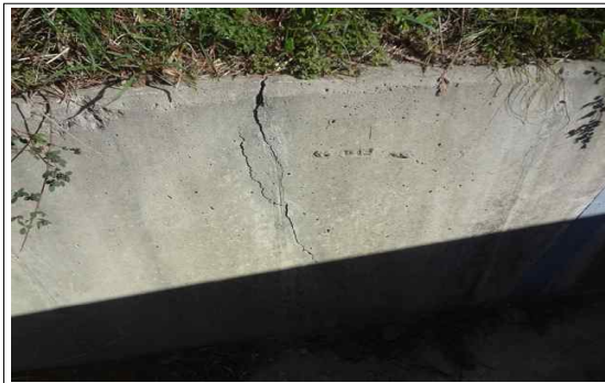
사면(시점부) STA.0-20 배수로 파손
