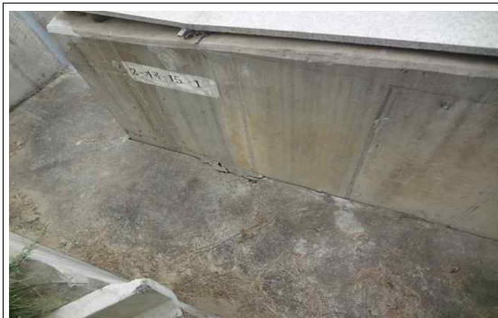
사면(중점부) STA.0+-10 배수로 파손
