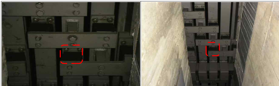
하행선 A1 신축이음 간격조절재 고정볼트 탈락
