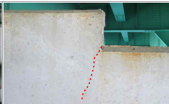
하행선 P1 코핑 배면 균열 (폭0.2mm)
