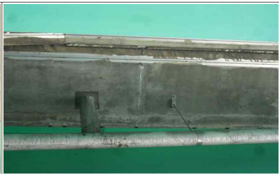
상행선 S3 균열부 바닥판 하면 균열부 백태
