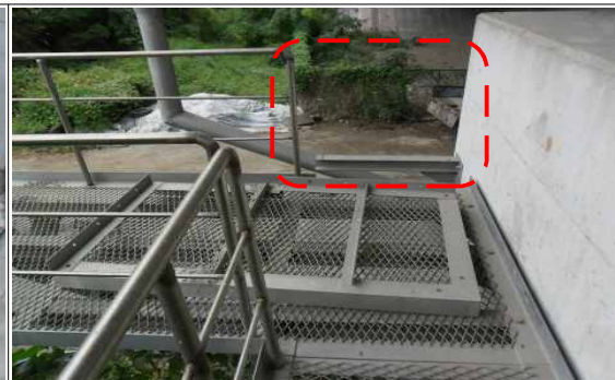
하행선 P16 점검로 탈락 (인위적 제거)
