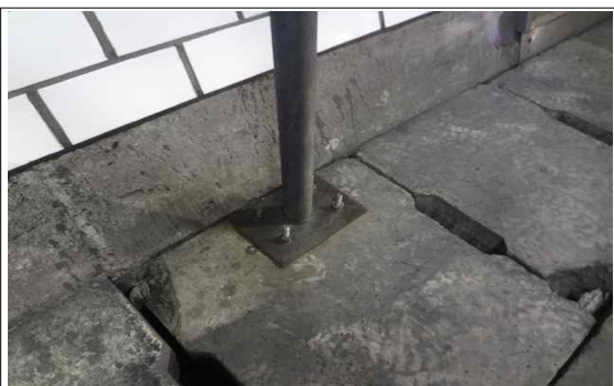
하행선 공동구 S13 이정표 볼트탈락
