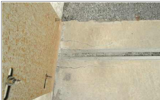
국도24호선방향 A1측 신축이음 후타재 박리 및 균열
