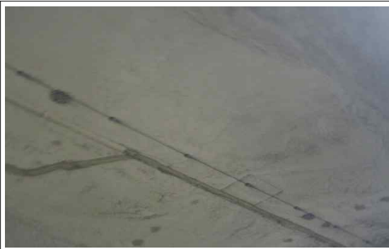
하행선 천정부 S42 균열 (폭 0.3mm)
