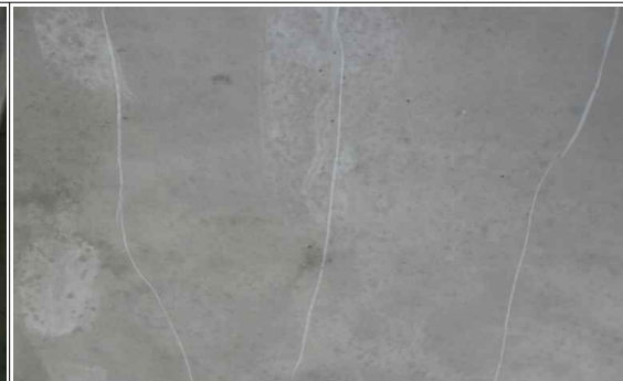
하행선 S6 주형외부 하부슬래브 종방향균열 (폭0.1mm)
