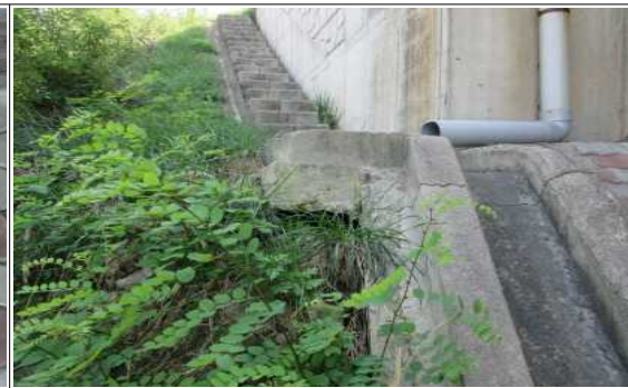
국도24호선방향 A2 점검계단 하부 토사유실 및 공동
