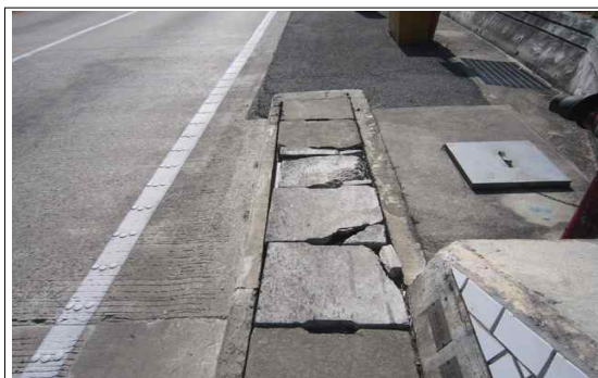
하행선 공동구 S1 덮개파손
