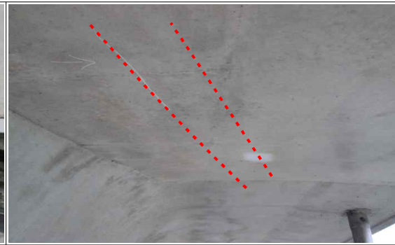
상행선 S1 주형외부 좌측 상부슬래브 종방향균열 (폭0.2mm)
