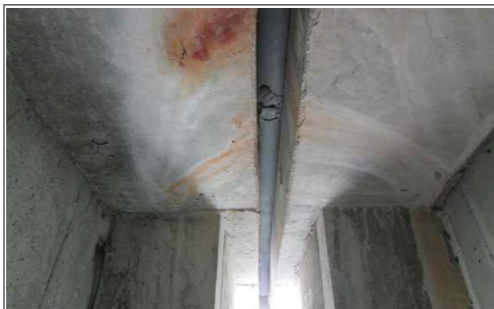
상행선 P2 신축이음 본체 하부 고무씰재 파손
