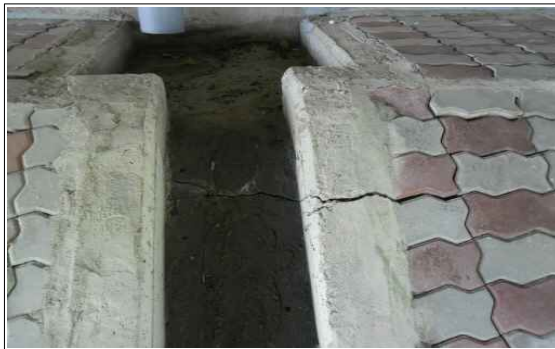
국도24호선방향 A1 배수로 균열
