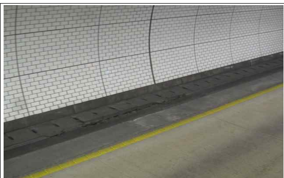
상행선 공동구 S44 콘크리트파손
