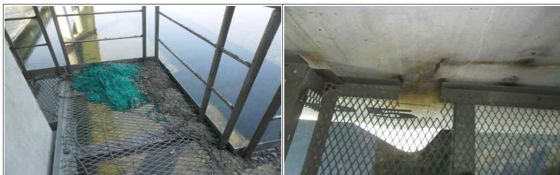
상행선 P1 점검로 이물질 퇴적 (폐콘크리트)
