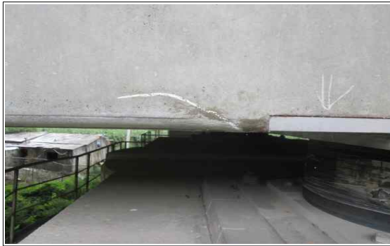
상행선 S1 P1지점 주형외부 받침부 균열 (폭0.2mm)
