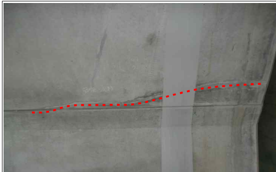
하행선 S1 A1측 주형외부 좌측면 균열 (폭0.2mm)
