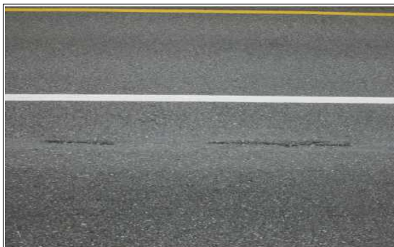
하행선 S4 교면포장 패임
