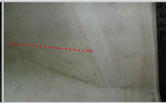
하행선 S1 주형외부 좌측상부슬래브 종방향균열 (폭0.2mm)
