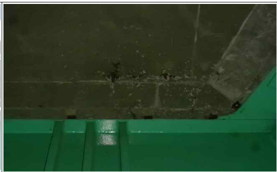
하행선 S3 바닥판하면 철근노출 및 재료분리
