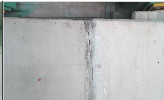
상·하행선 A2 벽체 실란트 파손
