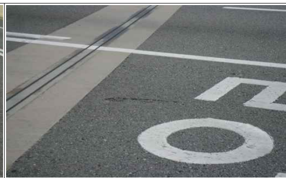
하행선 S3 교면포장 패임
