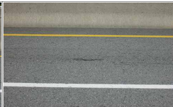
하행선 S2 교면포장 패임
