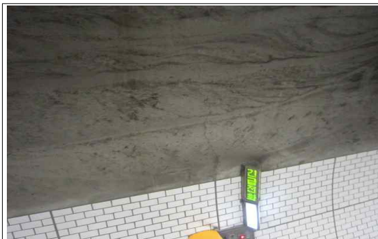
상행선 측벽부 S50 균열 (폭 0.3mm)
