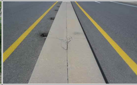
S5 중분대 상부 콘크리트 들뜸
