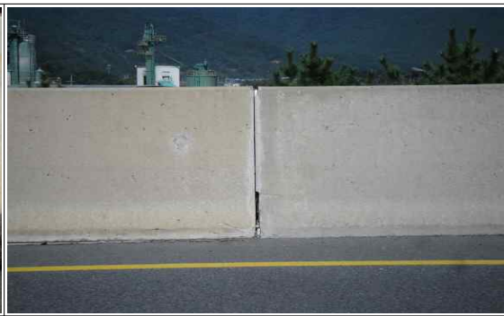
A2측 접속도로 구간 중분대 접합부 실란트 이격
