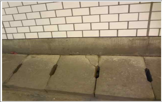
하행선 공동구 S53 덮개파손
