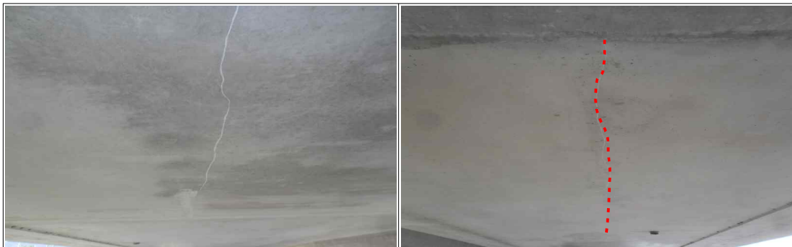
하행선 S7 주형외부 하부슬래브 중방향균열 (폭0.1mm)
