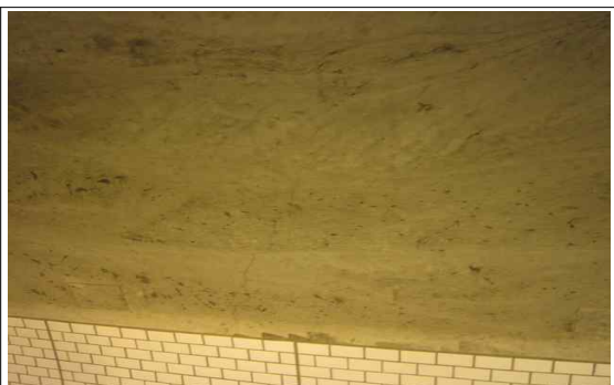
하행선 측벽부 S64 균열 (폭 0.3mm)
