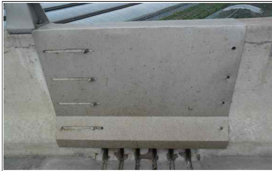
상행선 A1측 차수관 앵커볼트 탈락
