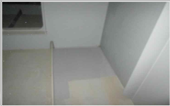
상행선 S8 G2 주형내부 이물질 퇴적 보수 현황
