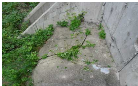
하행선 A2 점검계단 상부 콘크리트 파손
