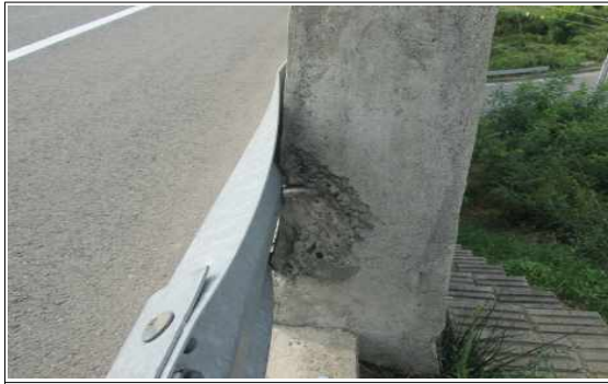
국도24호선방향 A2측 방호벽 콘크리트 파손 및 철근노출
