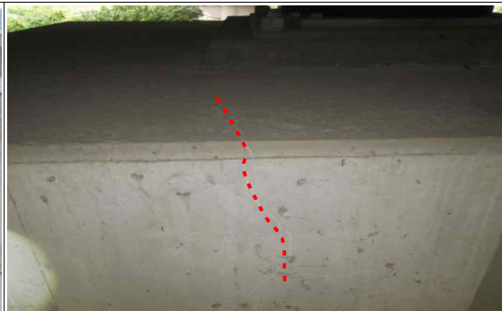
상행선 P10 코핑 배면 균열 (폭0.2mm)
