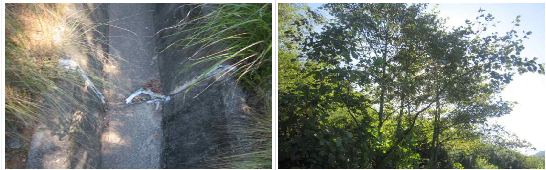
산마루측구 파손 및 실란트 파손 (50.53K 지점)
