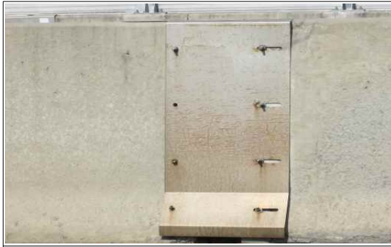
상행선 A2측 차수판 앵커 볼트 탈락
