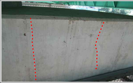
상행선 P5 코핑 정면 균열 (폭0.1~0.2mm)
