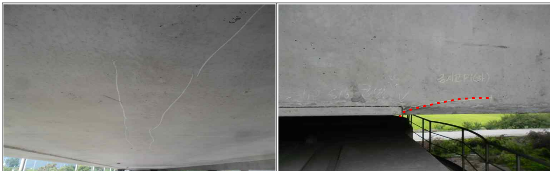
하행선 S8 주형외부 하부슬래브 중방향균열 (폭0.2mm)
