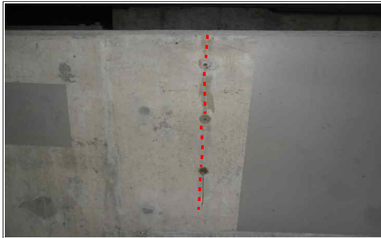
하행선 A1 벽체 보수부 재균열 (폭0.2mm)
