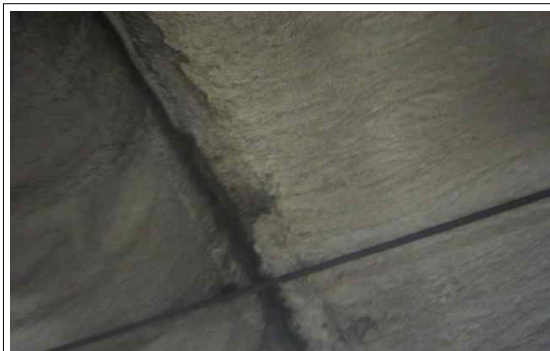
하행선 천정부 J61 콘크리트 탈락 (A=0.1X0.3)
