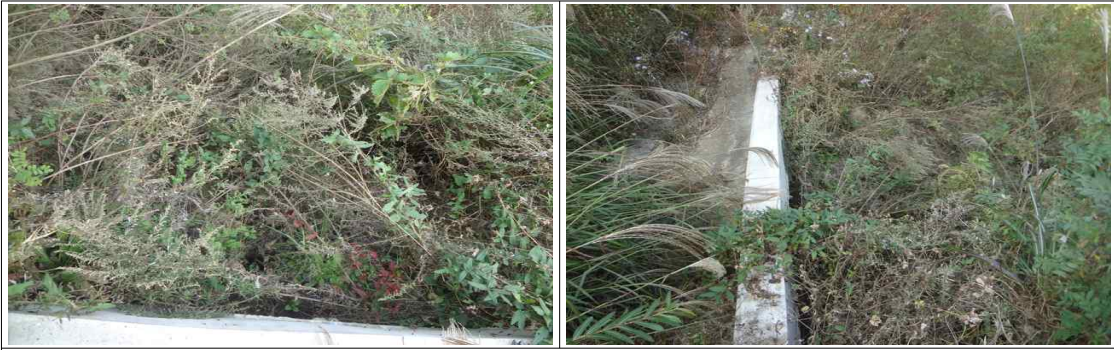
사면(시점부-우측) STA.41+750 3~4단 누수 및 유실
