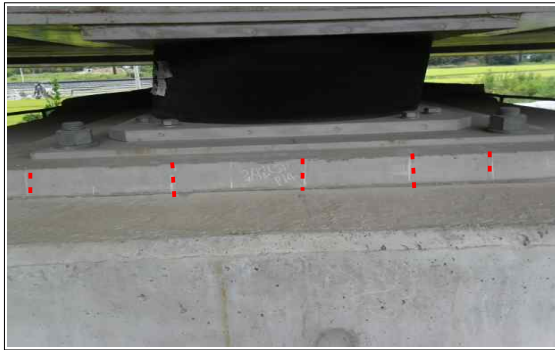
하행선 P14 SH2 무수축물탈 균열 (폭0.1mm)
