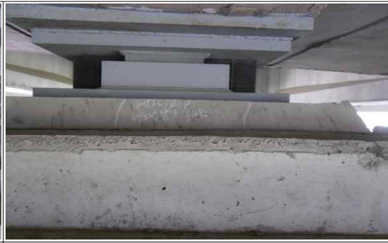
국도24호선방향 P1 SH8 무수축물탈 균열 (폭0.1mm)
