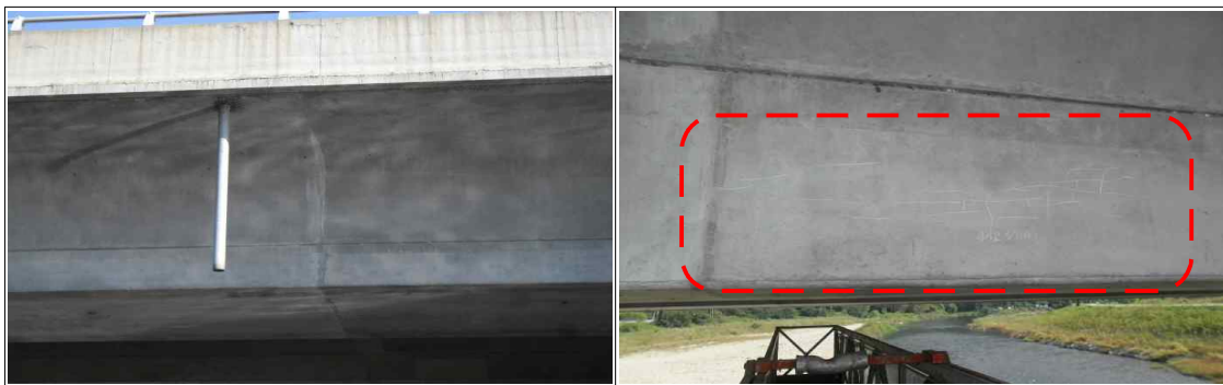
하행선 S7 주형외부 좌측 상부슬래브 백태
