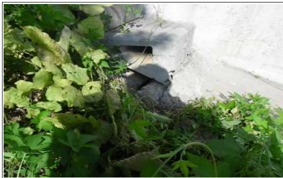
상행선 A1측 점검계단 하부 공동 발생
