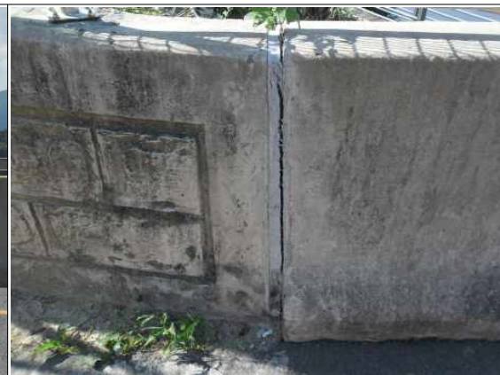
하행선 A1측 접속도로 구간 방호벽 실란트 파손
