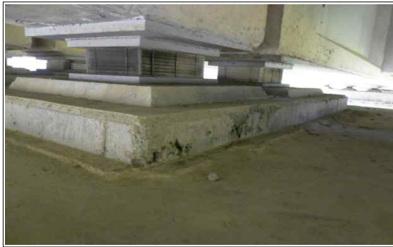
하행선 P2 SH9 받침콘크리트 재료분리
