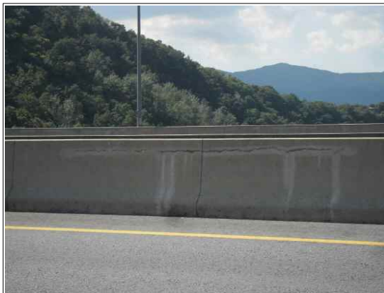
상행선 S2 방호벽 균열 (폭0.2mm)
