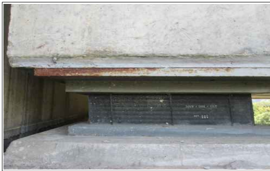
국도24호선방향 A2 SH1 Plate 녹발생
