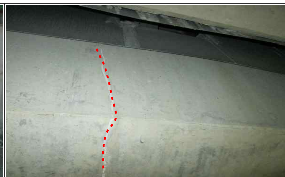
하행선 A1 홍벽 균열 (폭0.3mm)
