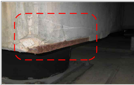
상행선 S17 A2측 주형외부 받침부 콘크리트 박리 및 파손
