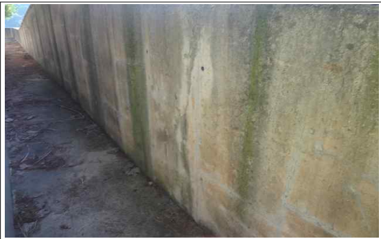
사면(시점부) STA.0-20 배면 배수로 균열
