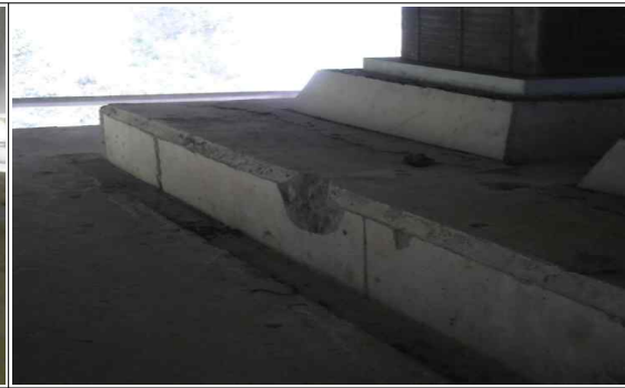
하행선 P3 SH5, SH111 받침콘크리트 파손
