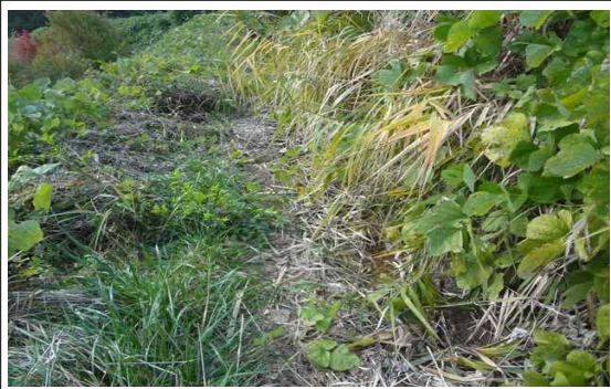
사면(시점부-정면) STA.0+0 1소단배수로 체수
