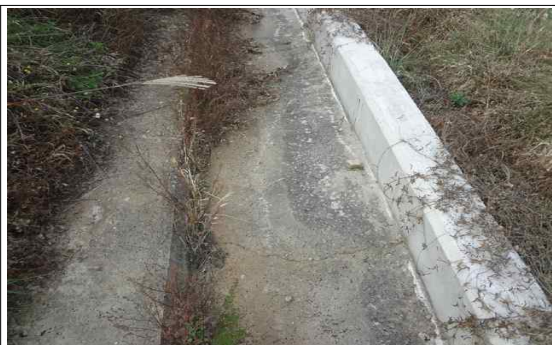
사면(시점부-우측) STA.41+660 소단배수로 균열
