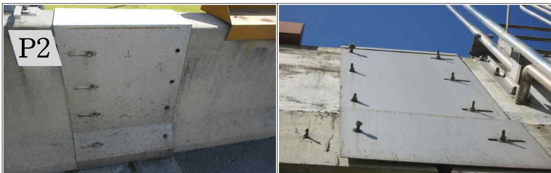
상행선 P2 차수판 앵커볼트 탈락
