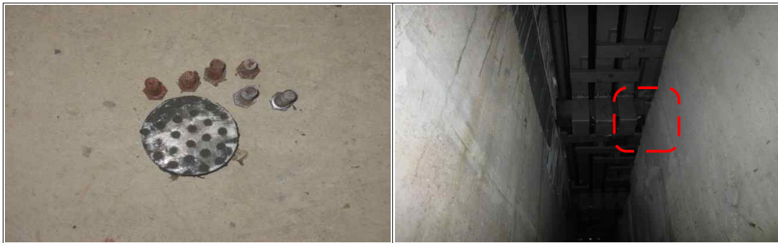
상행선 A2 신축이음 지지대 및 Bearing 탈락
