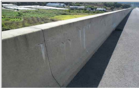
상행선 S5 방호벽 균열부 백태
