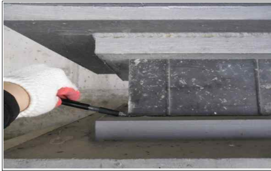
국도24호선방향 A1 SH4 탄성받침 들뜸
