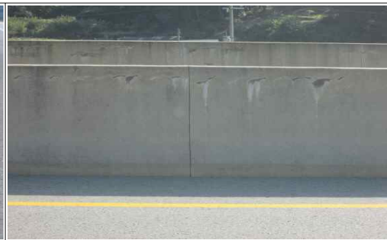
하행선 S2 방호벽 균열부 백태
