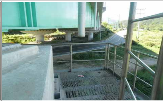
하행선 S3 P3측 배수관 유출구 위치 부적절 (교각 상부)
