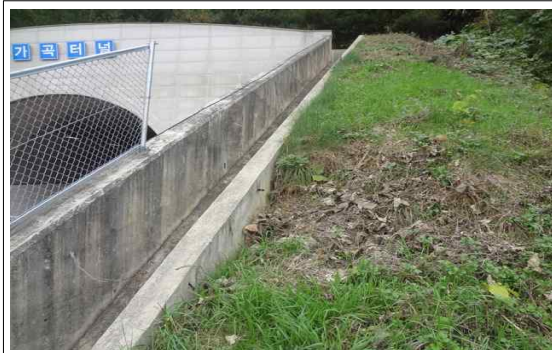
사면(중점부) STA.0+25 1단 토사유실
