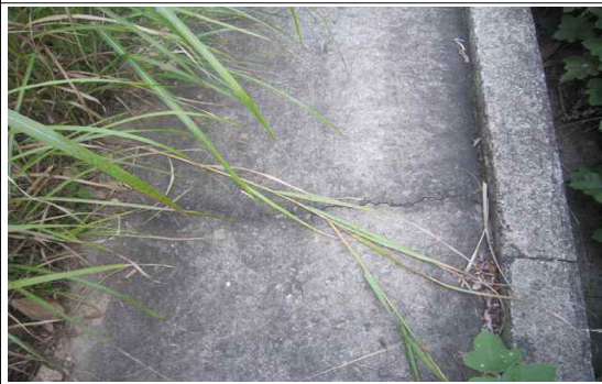
1소단배수로 균열 (50.49K 지점)
