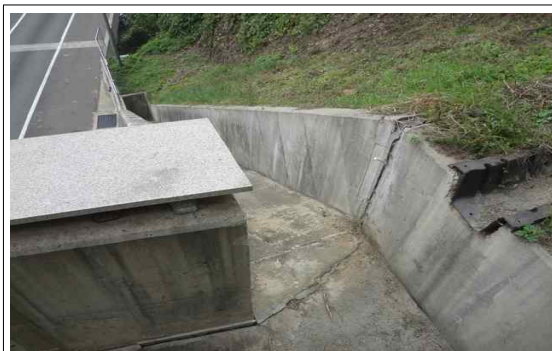
사면(중점부) STA.0-20 배수로 이격
