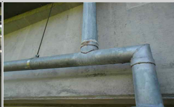
하행선 S1배수관 연결부 누수
