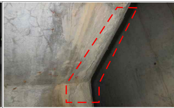
상행선 S17 A2측 주형외부 받침부 콘크리트 박리
