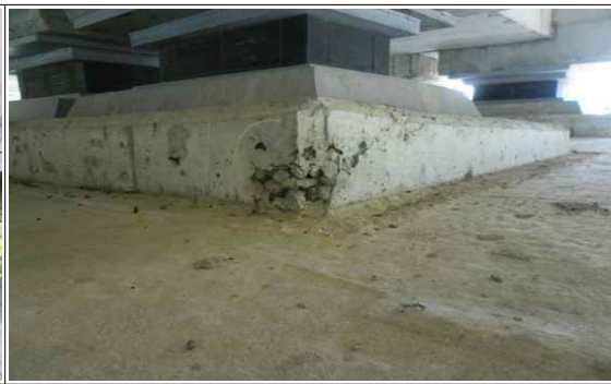
북밀양IC방향 P2 SH4 받침콘크리트 재료분리
