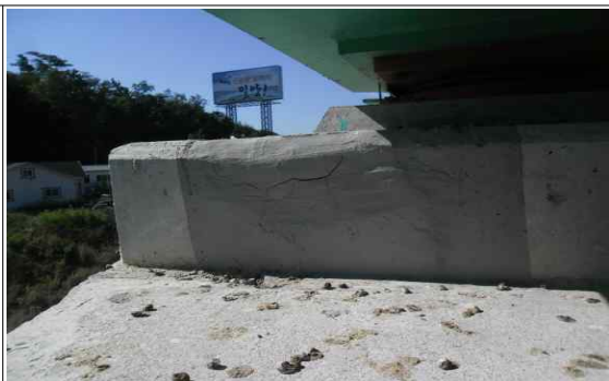
상행선 P4 SH8 받침콘크리트 보수부 재손상 (들뜸)
