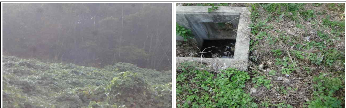
사면(중점부-정면) STA.0-10 자연사면 추가유실우려 구간
