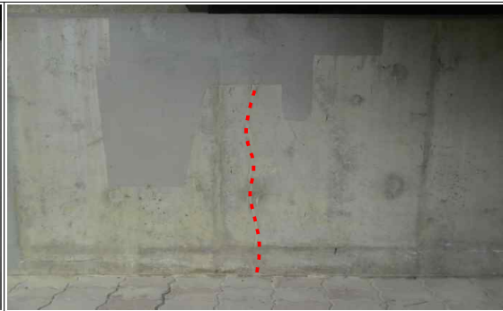
하행선 A2 벽체 균열 (폭0.2mm)
