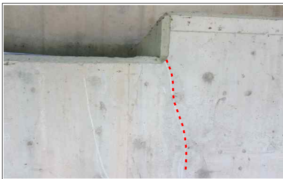
하행선 A1 교대 벽체 보수부 재균열 (폭0.2mm)
