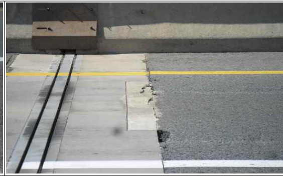
상행선 A2 신축이음 후타재 보수부 재파손
