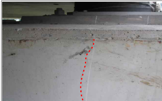
상행선 P1 코핑 정면 균열 (폭0.2mm)
