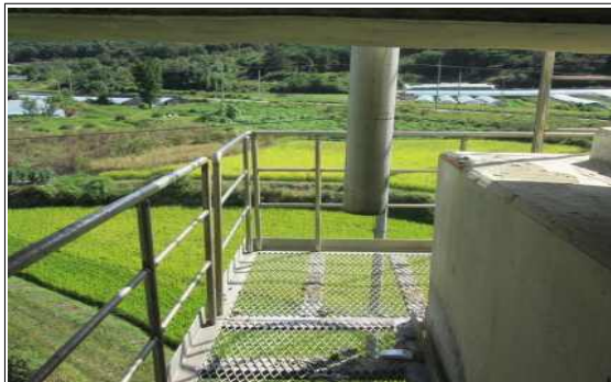
상행선S3 P2층 배수관 유출구 위치 부적절
