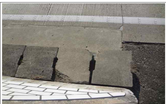
상행선 공동구 S75 덮개파손
