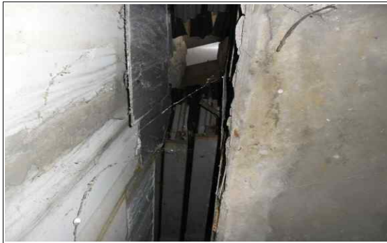
하행선 S1 A1측 유도배수관 배수관 길이부족
