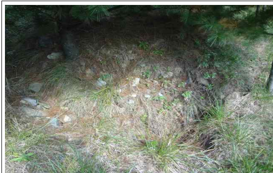
사면(시점부-정면) STA.0+5 1단 세굴
