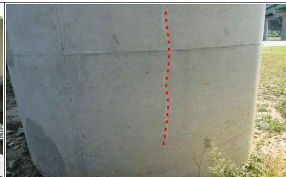
상행선 P5 기둥 배면 균열 (폭0.2mm)
