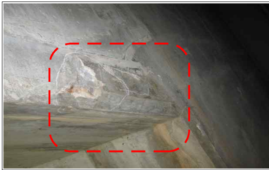
상행선 S17 A2측 주형외부 받침부 콘크리트 박리
