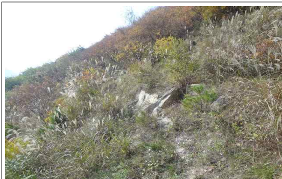
사면(시점부-좌측) STA.38+540 2단 암노출
