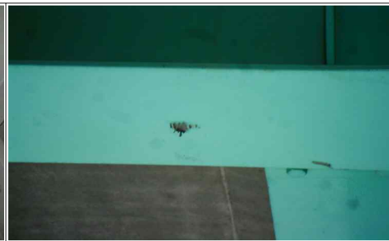
상행선 S2 가로보 도장손상
