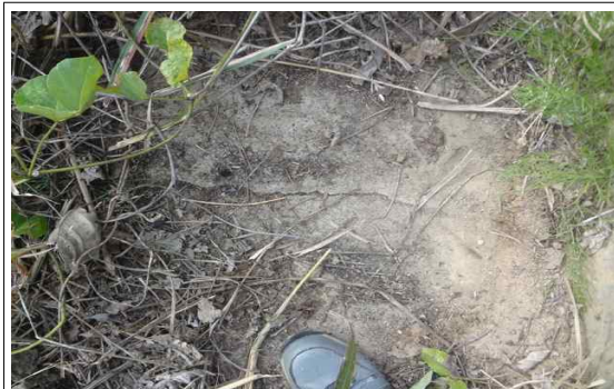
사면(시점부-정면) STA.0+10 1소단배수로 균열
