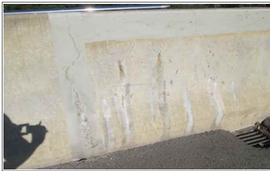
하행선 S6 방호벽 균열부 백태
