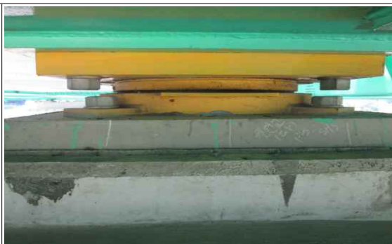
하행선 P5 SH3 무수축몰탈 균열 (폭0.1mm)
