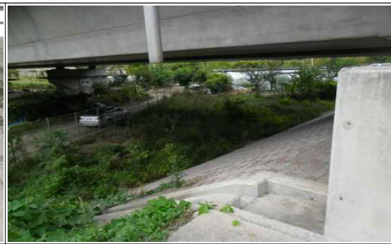
하행선 S1 (A1측) 배수관 위치 부적절 (교대법면 상부)
