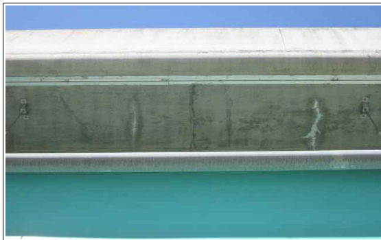
상행선 S8 바닥판하면 균열부 백태
