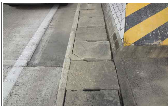
상행선 공동구 S1 덮개파손
