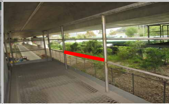
상행선 P11 점검로 안전난간 파손
