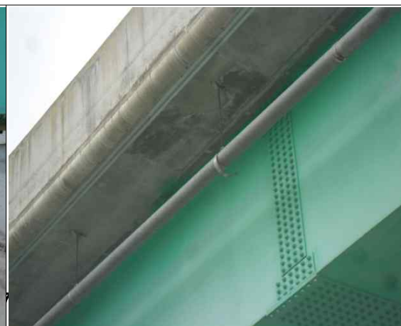
하행선 S6 배수관 연결고리 탈락
