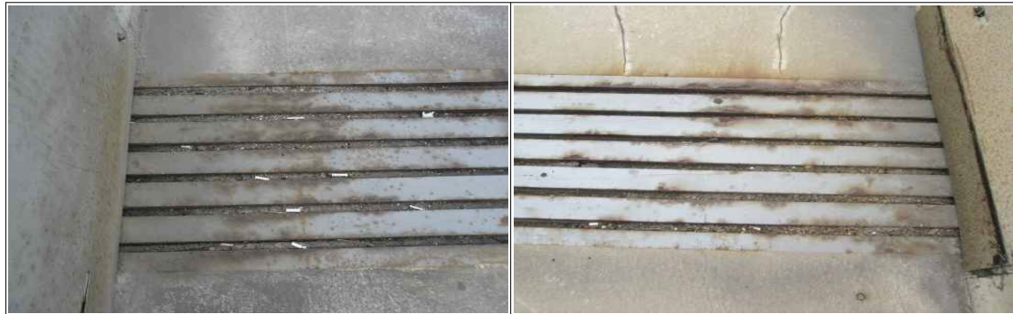
상행선 A2 신축이음 본체 녹발생 및 이물질 퇴적
