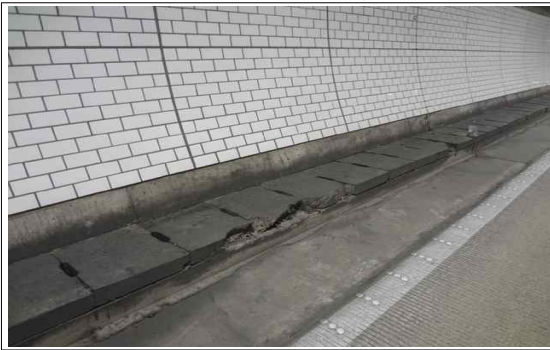
하행선 공동구 S33 덮개파손
