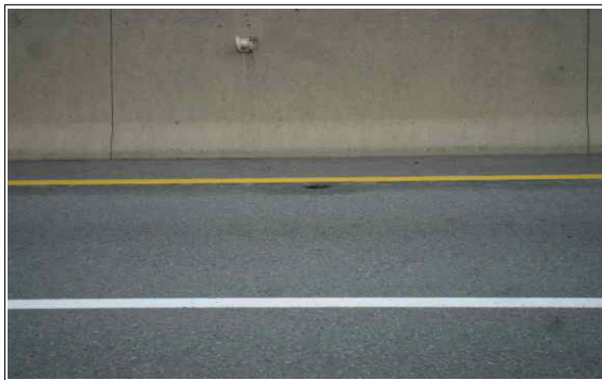
상행선 S2 교면포장 포트홀
