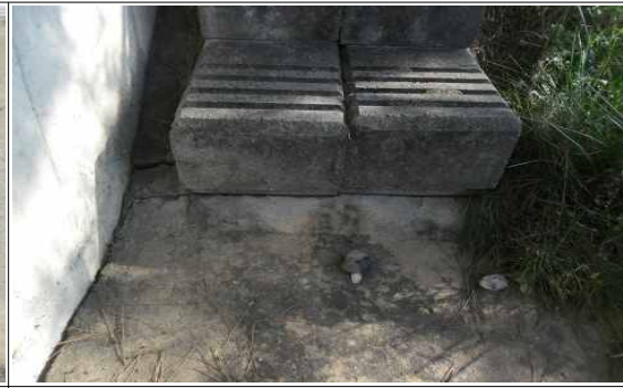
상행선 A2측 점검계단 하부 균열
