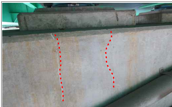
상행선 P1 코핑 배면 균열 (폭0.1mm)
