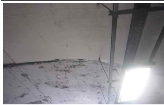
하행선 천정부 J6 콘크리트 들뜸 (A=0.1X1.0)
