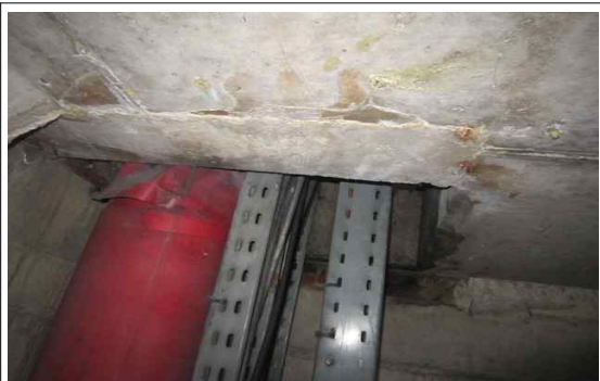
공동구내부 C면 천정부 연결홀 누수 및 백태 (STA.0+44)
