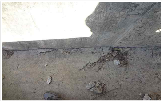
사면(시점부) STA.0+30 배수로 파손
