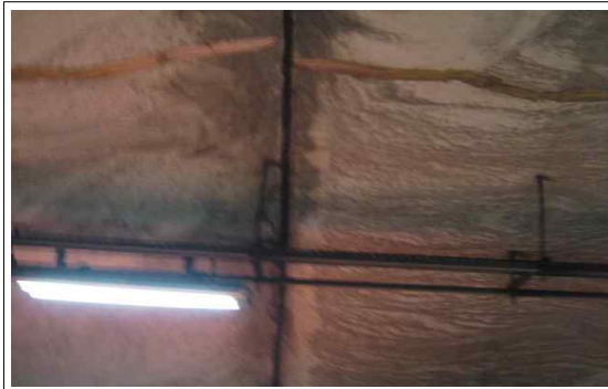
하행선 천정부 J33 콘크리트 들뜸 (A=0.1X0.2)
