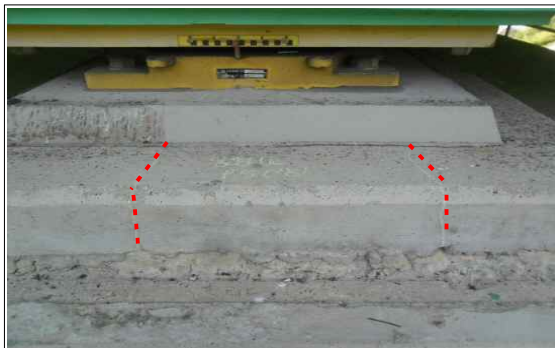
상행선 P5 SH4 받침 콘크리트 균열 (폭0.1mm)
