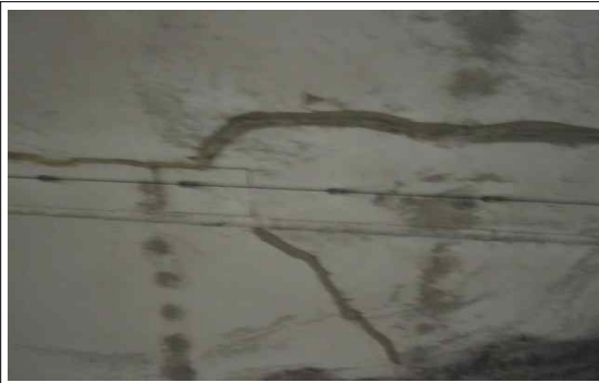
하행선 천정부 S17 균열 (폭 0.3mm)
