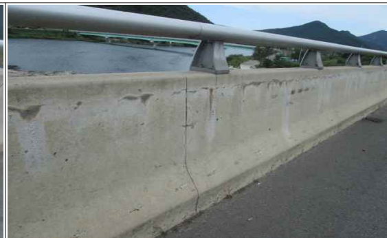
하행선 S7 방호벽 균열부 백태
