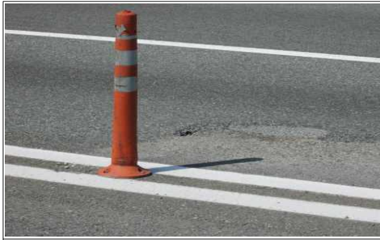
상행선 S1 교면포장 패임
