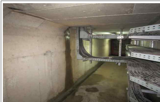
공동구내부 C면 천정부 연결홀 누수 (STA.0+44)
