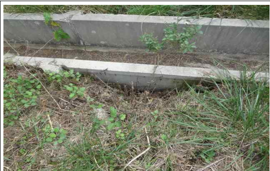
사면(시점부-정면) STA.0+5 1단 배수로 뒷채움 부족
