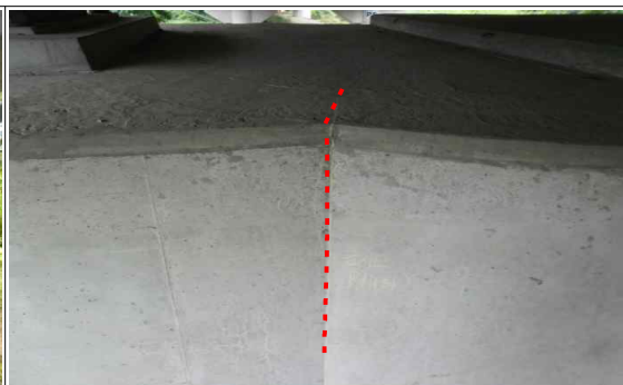
하행선 P11 코핑 정면 균열 (폭0.2mm)
