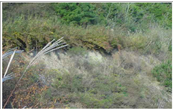
사면(시점부-정면) STA.0-20 4단 식생불량
