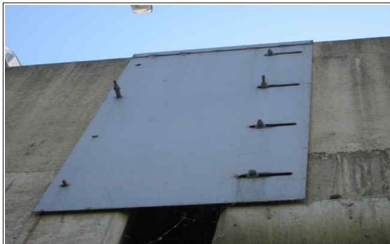
하행선 A2측 차수판 앵커볼트 탈락
