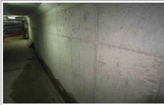
공동구내부 C면 좌측벽 재료분리 (STA.0+10)
