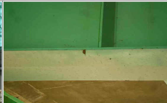
상행선 S4 가로보 도장손상
