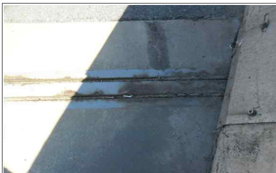
상행선 P4 신축이음 이물질퇴적 및 녹발생
