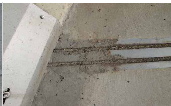
하행선 P4 신축이음 이물질퇴적 및 녹발생
