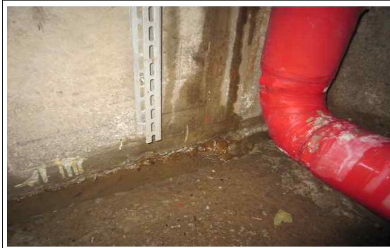
공동구내부 C면 좌측벽 누수 (STA.0+29)
