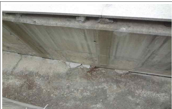
사면(중점부) STA.0-20 배수로 파손
