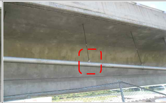
상행선 S6 배수관 연결고리 탈락
