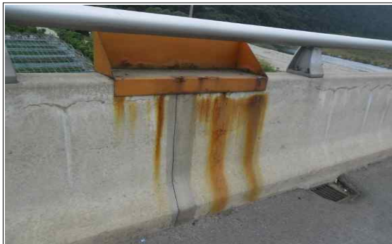
상행선 S8 방호벽 녹물오염 및 균열부 백태
