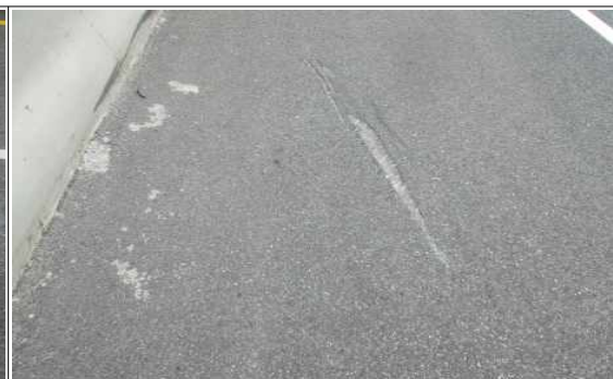
하행선 S5 교면포장 패임
