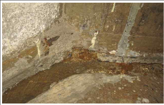
공동구내부 C면 좌측벽 누수 (STA.0+20)
