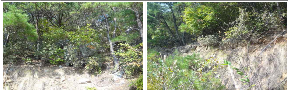
사면(시점부-좌측) STA.38+540 자연사면 암괴
