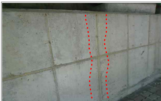
상행선 A1 벽체 균열 (폭0.2mm)
